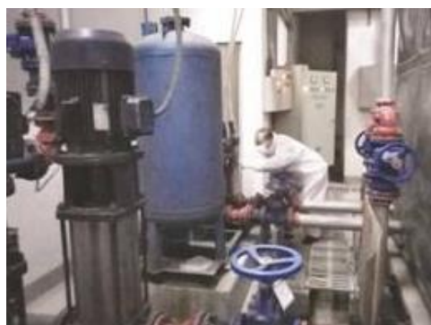
夏守云亲自到地下室查看锅炉故障
